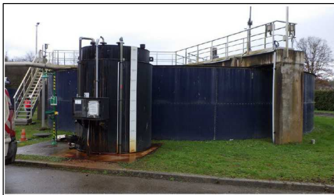
Bassin d'aération de la STEP de RENAZE
